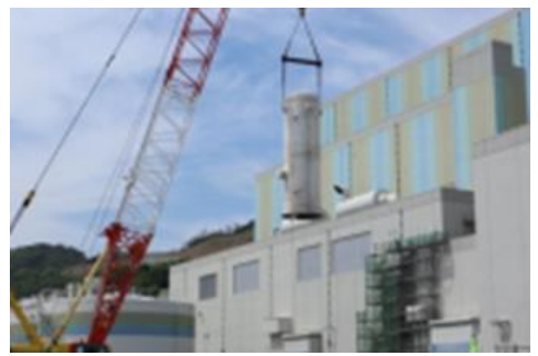
フィルタ付バント設備の設置(3号機)
