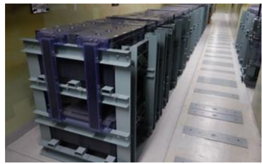
直流電源の確保に向けた蓄電池の強化
