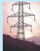
220kV送電線 (中国東幹線)
