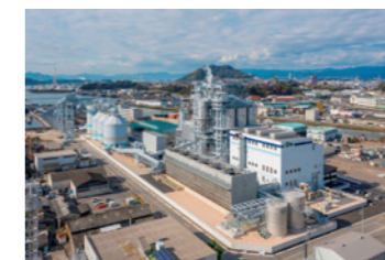
国内最大規模のバイオマス混焼発電所である海田発電所
