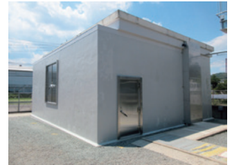
[変電所浸水防止対策](水密化)
