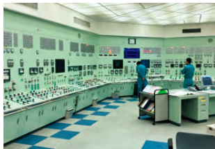
シミュレータ施設風景
