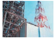
下松発電所2号機の脱硝装置
