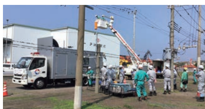
九州電力送配電(株)仕様の電線を用いた仮復旧工法による断線修理、高圧発電機車による応急送電訓練を実施(2022年5月)
