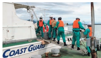
第六管区海上保安本部 柳井海上保安署巡視艇「くががぜ」 による復旧資機材・人員の輸送(2022年9月:台風11号の影響による山口県柳井市平都島における停電の復旧作業)
