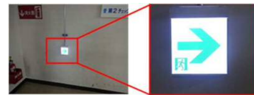
通路誘導灯（廊下・通路）
