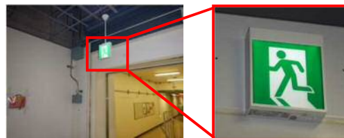
避難口誘導灯
