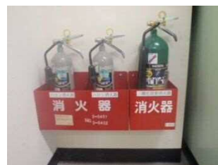
消火器設置状況
