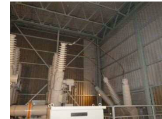
66kV予備変圧器1次側
