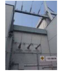
66kV送電線引込部
