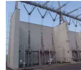
220kV送電線引込部
