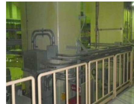
電線管及び端子箱
