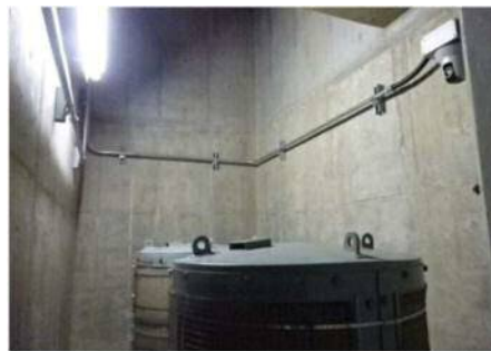
非常用ディーゼル発電機 給気消音器フィルタ室
