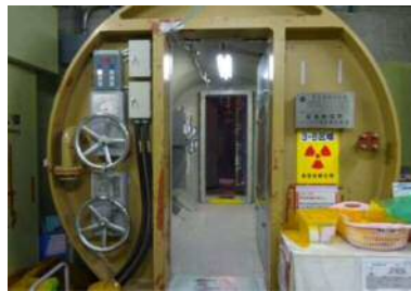
格納容器所員用エアロック
