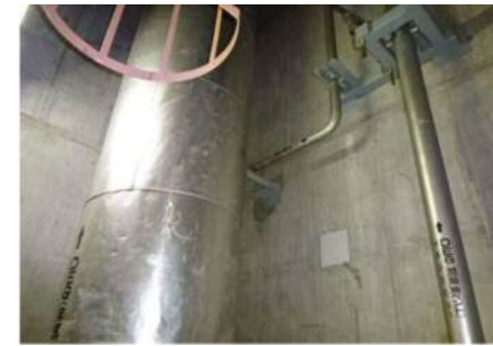
非常用ディーゼル発電機 排気管室
