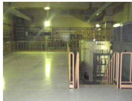
RCW サージタンク及び計器ラック
