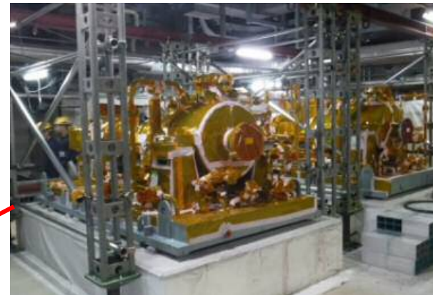
<残留熱代替除去ポンプ外観>
