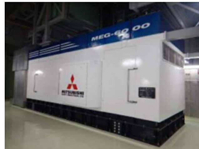
<ガスタービン発電機>
