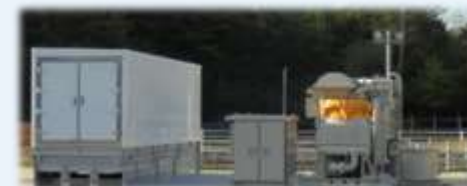
《移動用変電所》
