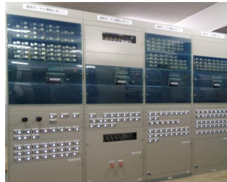
制御装置（親局）の外観
