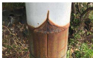
鋼管部下端が著しく錆びている(錆の長さが4cm以上)
