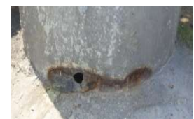
雲母状の錆で穴が空いている
