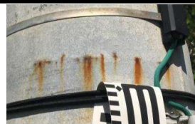
鋼管部(台柱型式票の約75cm上)が変形し、錆が発生
