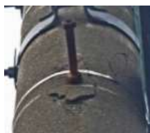
剥離(浮きあり)
