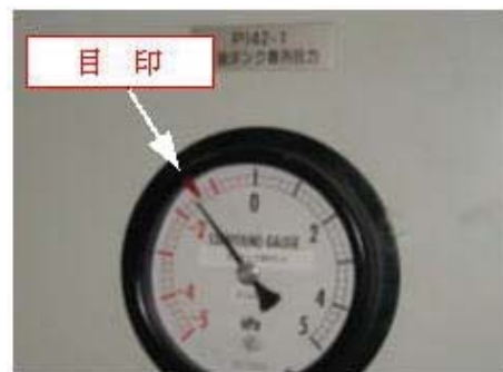
図3 主油タンク器内圧力計
