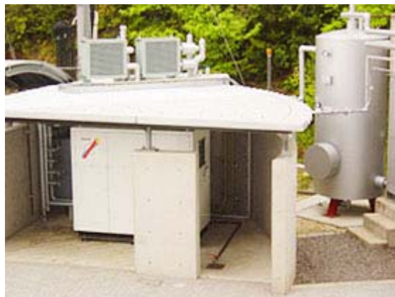
写真(システム全景)
