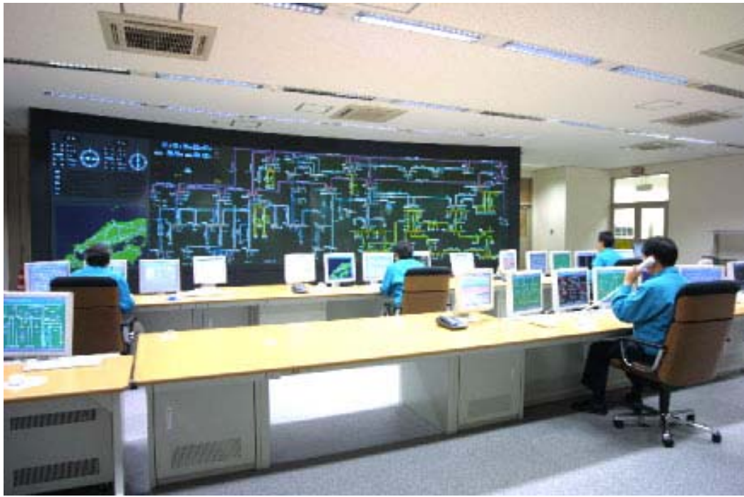
図1 基幹給電制御所指令室
