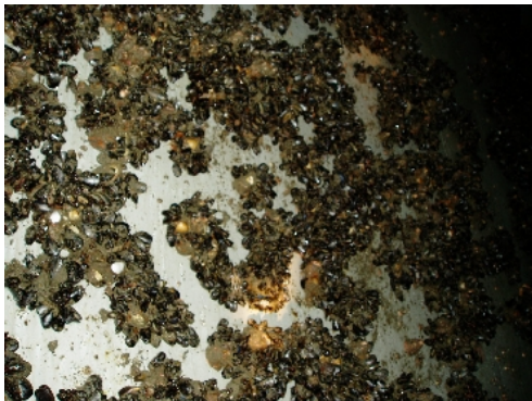
取水路への付着状況
