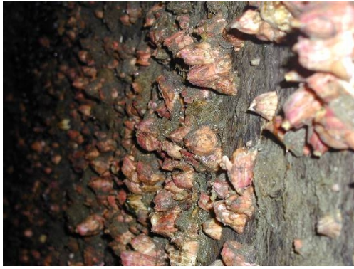
取水路への付着状況
