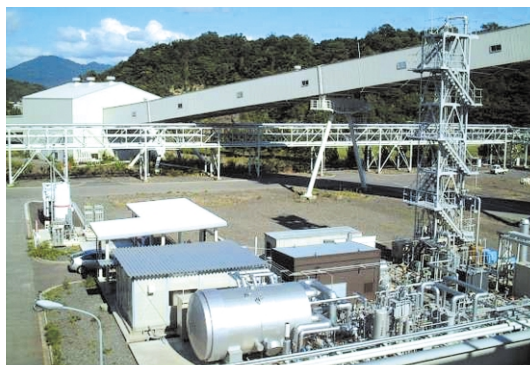
▲ 試験装置外観(三隅発電所設置)
