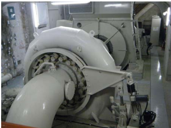
土居発電所 水車・発電機
