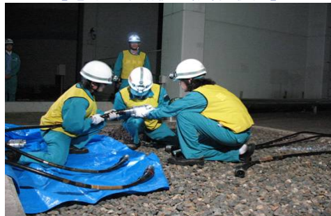
【電源の早期復旧訓練：夜間】
