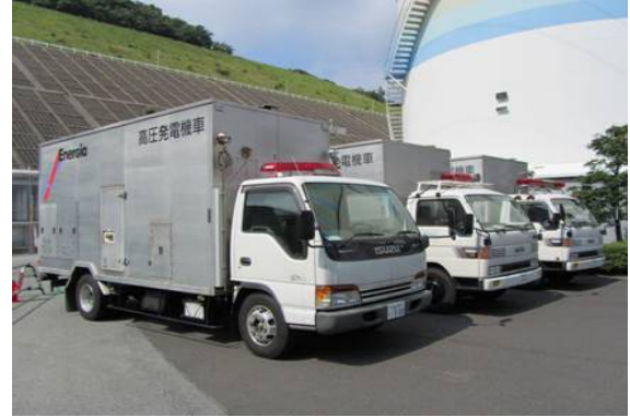
【高圧発電機車】
