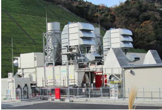
【ガスタービン発電機の外観】
