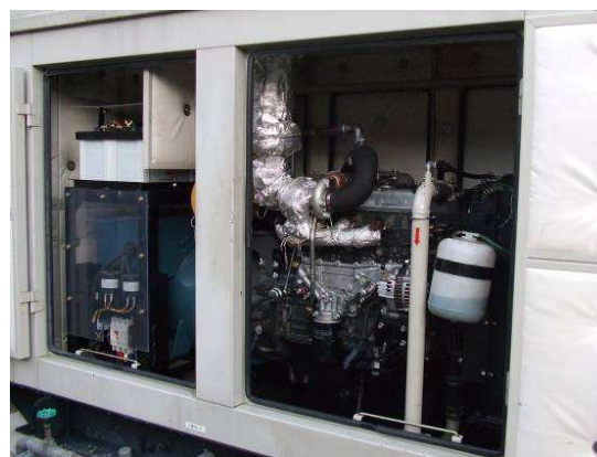
実証試験装置（内部）
