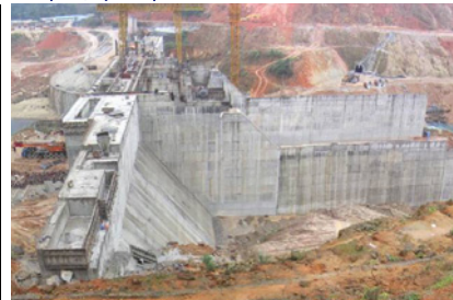
【水力発電所開発コンサルティング】 (ベトナム)
