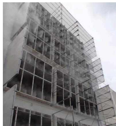
【柳井発電所 吸気冷却装置】
