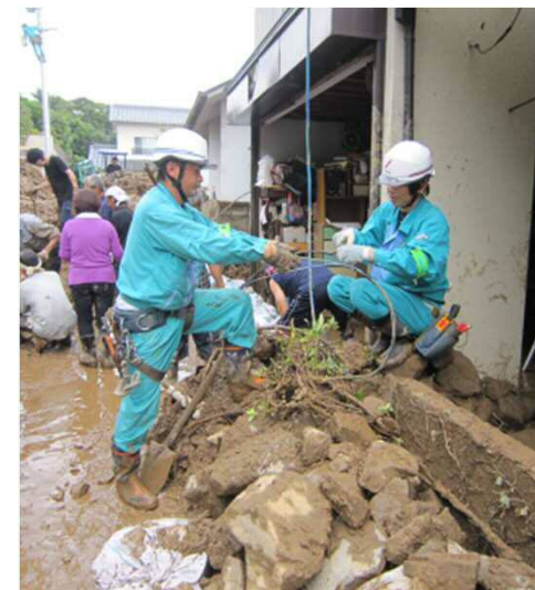
【安全確認のうえ送電】
