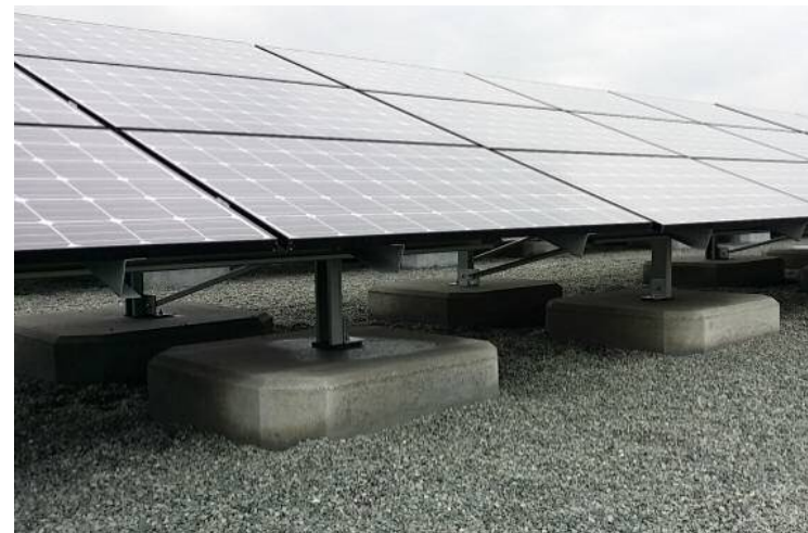
【当社宇部太陽光発電所基礎ブロック】
