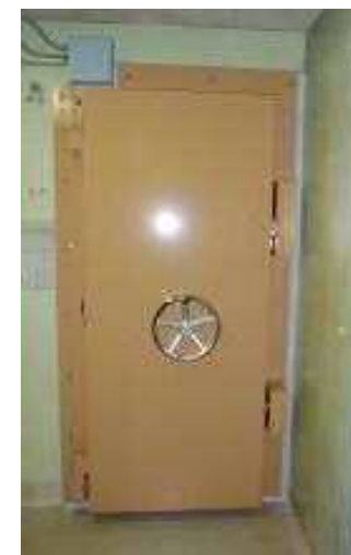
2号機建物内の水密扉
