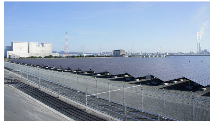
【宇部太陽光発電所】
