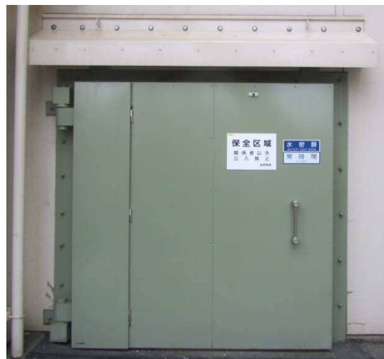
2号機建物外壁に設置した水密扉
