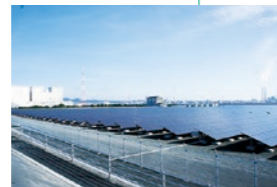
宇部太陽光発電所 0.3万kW
