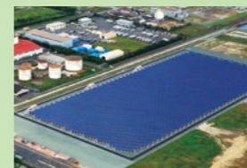
福山太陽光発電所 0.3万kW
