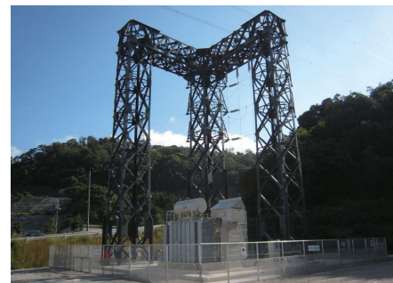
66kV受電設備
