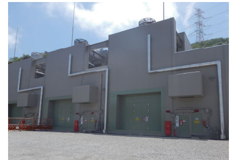
ガスタービン発電機
