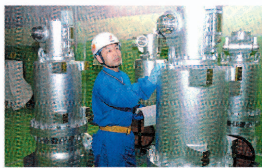
取替を前に新しい主蒸気減し弁(安全弁)を確認する澤田さん
